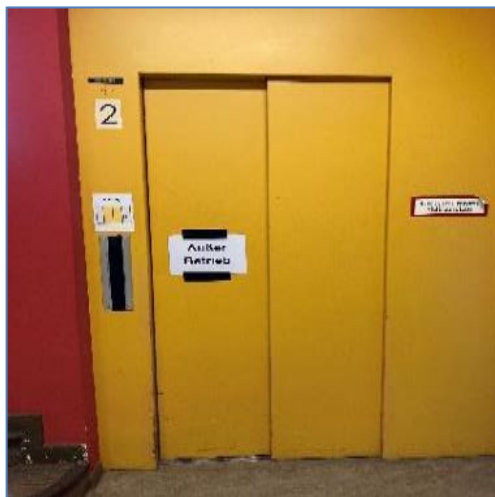
Stillgelegter Aufzug (Foto: Rechnungshof, 2023)
