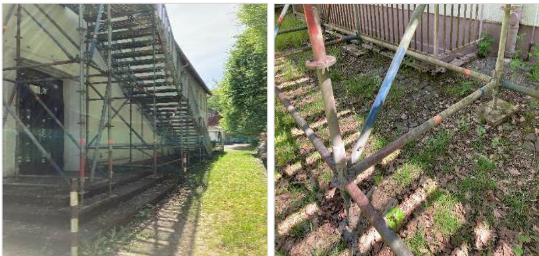
Provisorischer Rettungsweg aus dem Obergeschoss Geb. 010 auf maroden Standplatten (Fotos: Rechnungshof, Mai 2023)
